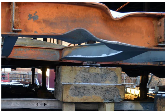
Рис. 3. Деформация металлической балки от действия высокой температуры - пожара
