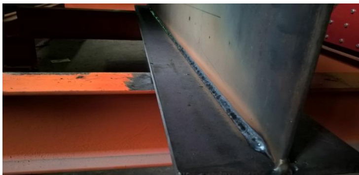
Рис. 1. Дефект изготовления – прожог металла
